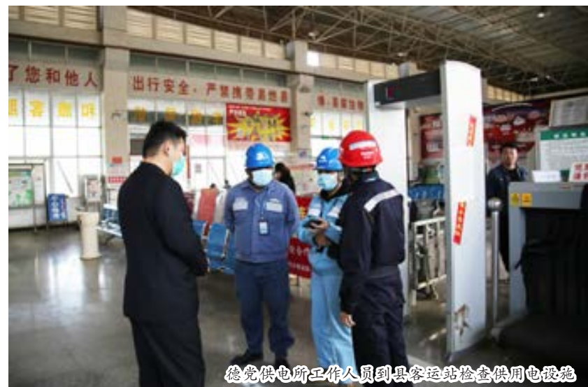
德党供电所工作人员到县客运站检查供电设施
