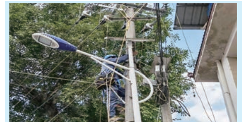
近日,云县供电局配电网管理一所在接到用户报障信息后,立即前往故障现场勘察,发现由于天气骤冷用户用电负荷增大、风力过大等因素,导致35千伏茂兰变电站10千伏芒草小茂兰支线小茂兰公用变0.4千伏架空线路断线,该配电网管理一迅速开展抢修工作,及时恢复20余户居民的用电。图为工人正在抢修电路。
